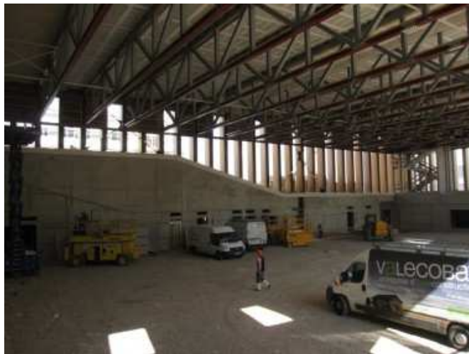
© Julien Rouby Les poutres treillis en cours d'habillage. Le métal apporte sa légèreté et sa finesse, tandis que le bois garantit la protection au feu
